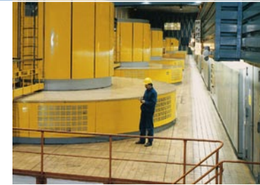
Maschinenkaverne Pumpspeicher-Kraftwerk Markersbach
