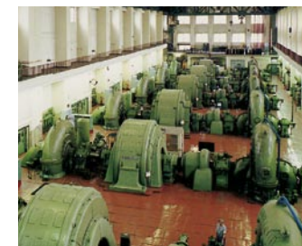
Maschinenhaus des Pumpspeicher-Kraftwerks Niederwartha
