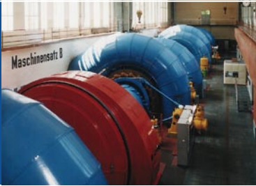
Maschinensätze des Pumpspeicher-Kraftwerks Bleiloch
