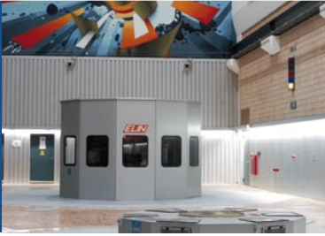
Maschinenhaus im Pumpspeicher-Kraftwerk Goldisthal
