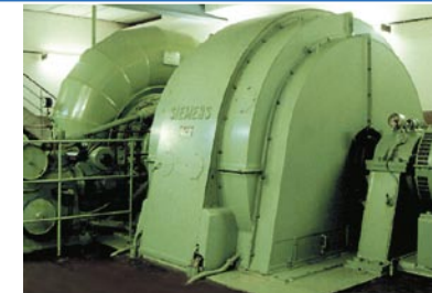
Laufwasser-Maschinensatz im Kraftwerk Hohenwarte I
