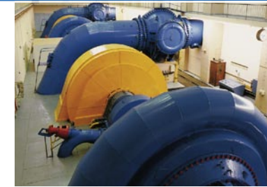
Pumpspeichersätze im Pumpspeicher-Kraftwerk Wendefurth
