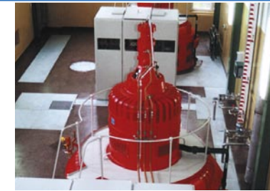
Maschinenhaus Laufwasser-Kraftwerk Eichicht
