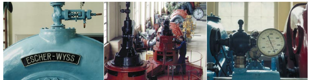
Blick in das Maschinenhaus des Laufwasser-Kraftwerks Wisenta
